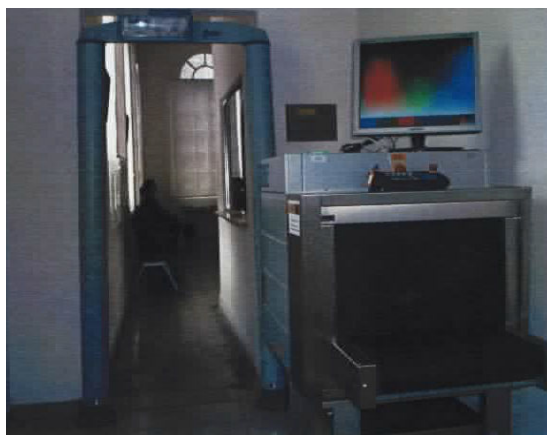
Sistema de seguridad ubicado en el Consulado de España en Panamá (Panamá)
