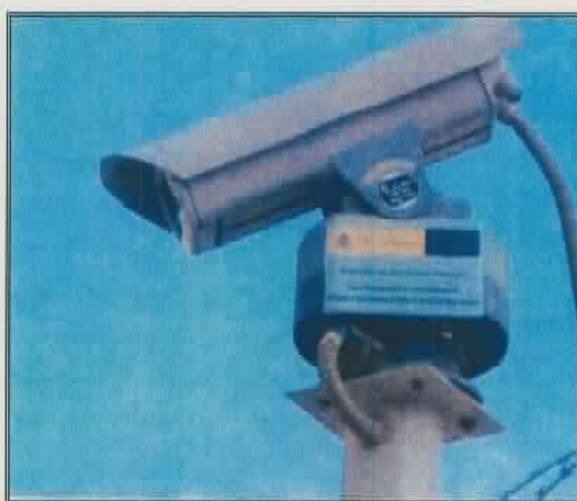
Sistema CCTV ubicado en la cancellería de la Embajada de España en Riad (Arabia Saudi)
