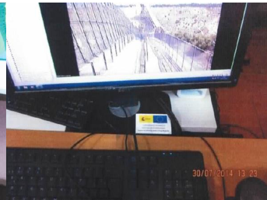
UPS y Rack de Comunicaciones
