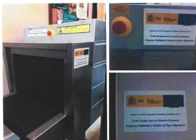
Equipamiento para control de acceso
