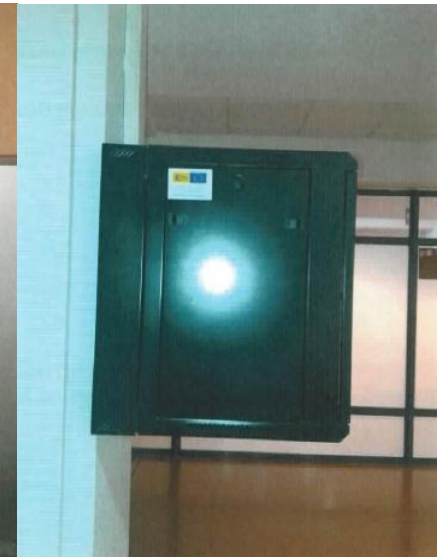
Rack de comunicaciones
