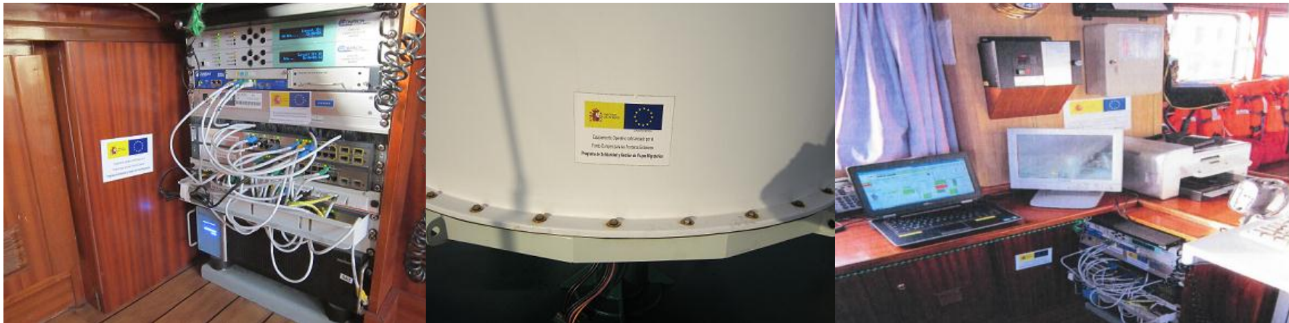
Rack de comunicaciones, antena bola y puesto control del sistema
